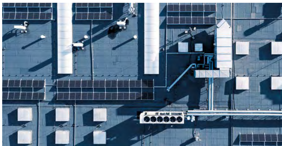
Gebäudetechnik auf einem Flachdach
