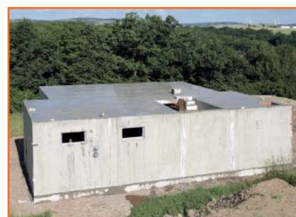
16.00 Uhr Zum Schluss werden Wände und Decken zusammen mit Ortbeton ausgegossen. Fertig ist der Keller!
